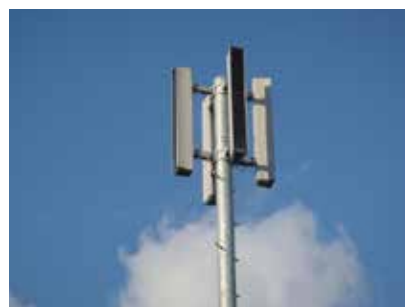
更新した防災行政無線屋外拡声子局
